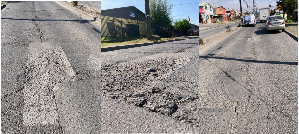
Bache Avda. Estación 2 , 2.00x9.00m. Entre Calles Rodolfo Seguel - Carlos Puentes (18.00m 2 ).
