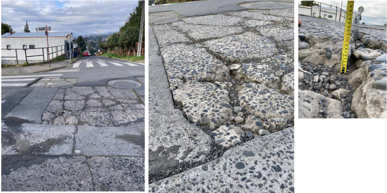
Bache Intersección Freire-Bulnes , 5.00.x8.00m. (40.00m 2 )
