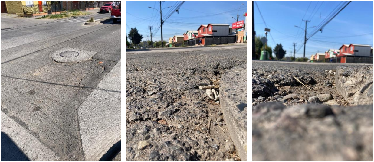
Bache Avda. Estación 3 , 3.00x4.00m. Intersección Avda. Estación - San Gregorio (12.00m 2 ).
